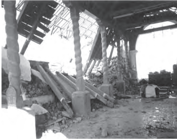
Fotografía 5. Interior colapsado de la iglesia de la villa Santa María de Ostuma después del sismo del 13 de febrero. (Fotografía: L. Teresa Guevara P.)
