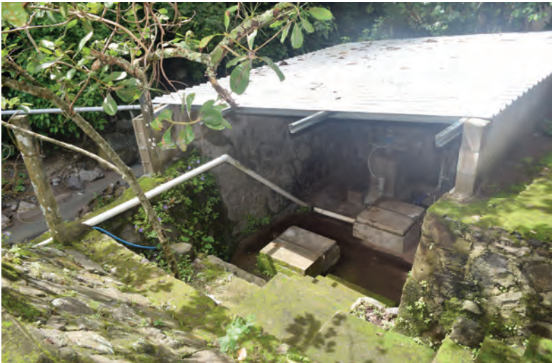
Fotografía 118. Caseta del circuito eléctrico de la bomba de sistema de agua potable en Santa María Ostuma, ubicado en el Cantón y caserío El Transito. Fotografía tomada por Miguel Ángel Hernández Vásquez
