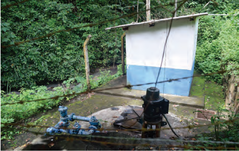
Fotografía 120. Sistema agua potable del ANDA, a un costado del sistema de agua en Santa María Ostuma, ubicado en el Cantón y caserío El Transito. Fotografía tomada por Miguel Ángel Hernández Vásquez
