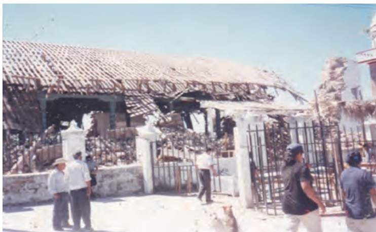
Fotografía 4. Fachada parroquial luego del terremoto del 2001. (Recuperada del video realizado por la Red Juvenil de Ostuma 2011)
