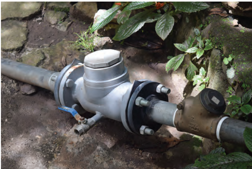
Fotografía 119. Detalle de sistema de agua potable en Santa María Ostuma, ubicado en el Cantón y caserío El Transito. Fotografía tomada por Miguel Ángel Hernández Vásquez
