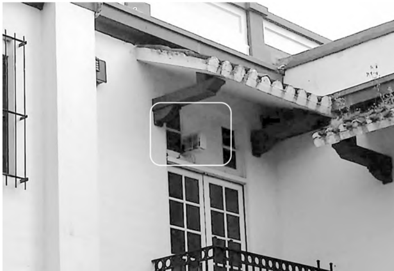
Figura 25. Nodo IoT instalado en fachada de edificio en la Utec. Fuente: diseño
