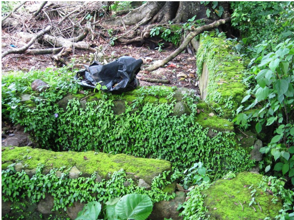
Imágenes 5 y 6 (superior e inferior respectivamente). Se muestra parte de los muros y paredes de las pilas del obraje de añil del tipo “hidráulico”, del sitio Achichilco II, San Vicente.
