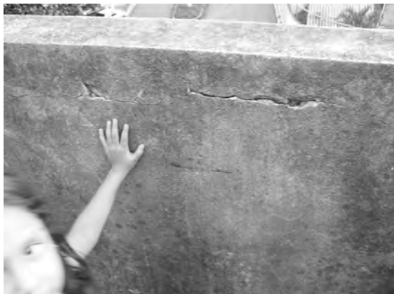
Foto 25. Detalle de las grietas en las paredes. (Fuente: fotografía tomada por la autora.)
