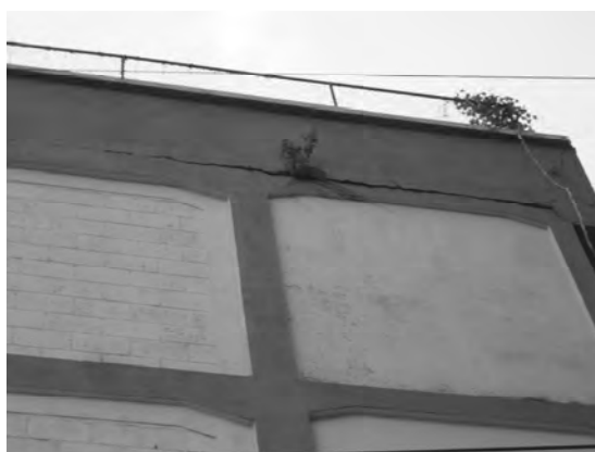
Foto 24. Estado actual del edificio. Nótase la grieta en el área en que la pared se una con la losa. (Fuente: fotografía tomada por la autora.)
