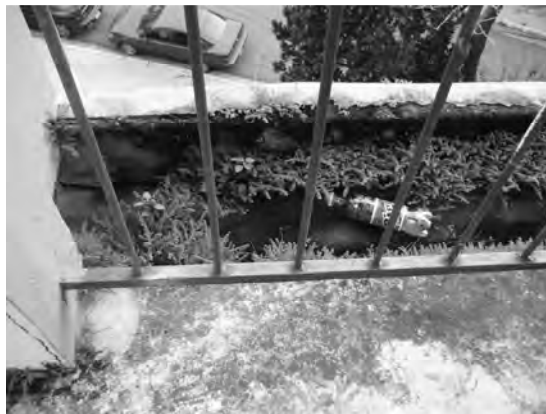
Foto 26. Vegetación espontánea dentro de los canales de drenaje de la azotea. (Fuente: fotografía tomada por la autora.)
