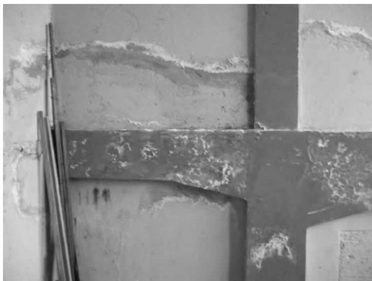
Foto 75. Manchas de humedad en las paredes del cubo de escaleras de uno de los edificios del Centro Urbano Lourdes, San Salvador. (Fuente: fotografía tomada por la autora.)
